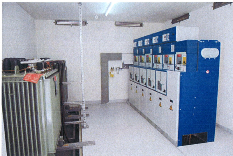
Blick in den sanierten Hochspannungs-Raum der TS Rauti
