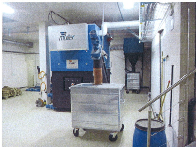
Die unterirdische Heizzentrale mit dem Schnitzelholz-Brenner.
