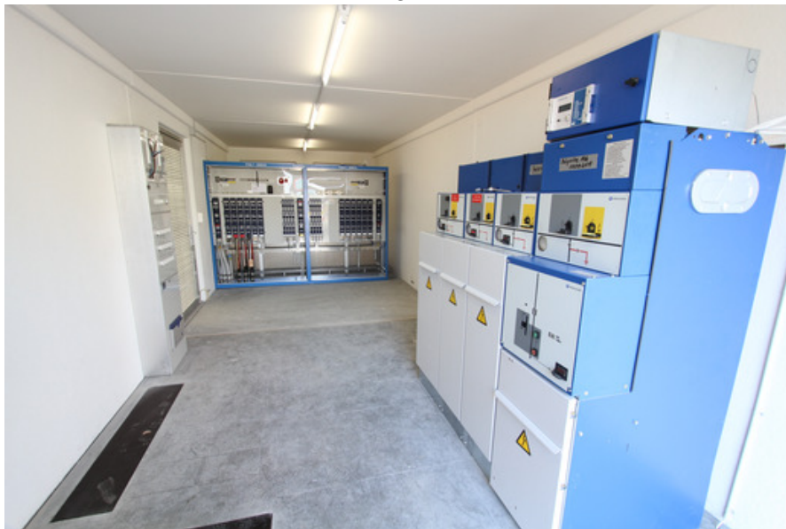
Blick in die TS Rotbrückstrasse
