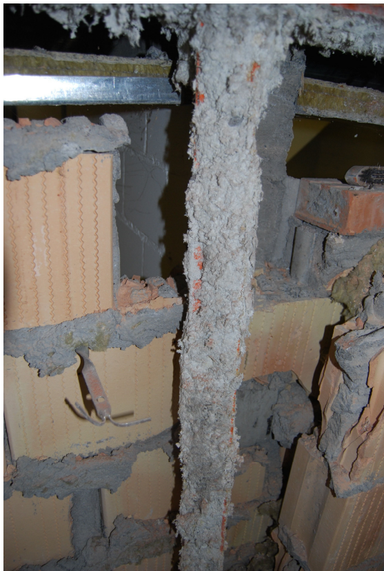
Träger mit Spritzasbest
