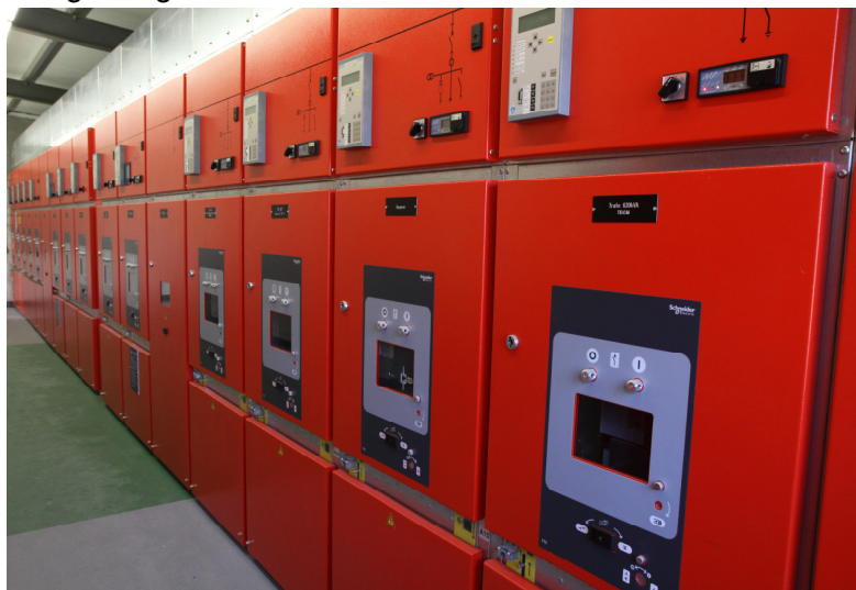
Die neue Hochspannungs-Schaltanlage in der MS Frühatzung
