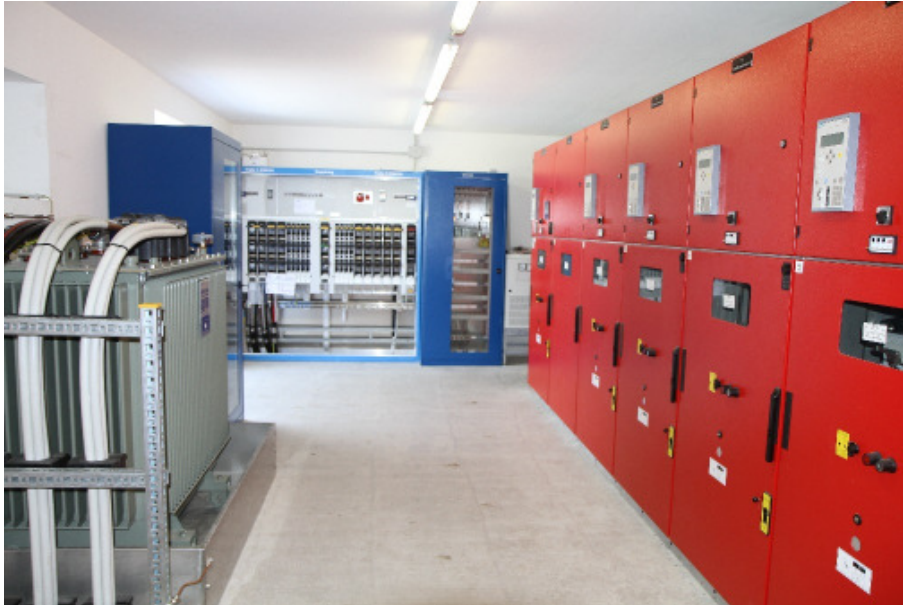
Blick in die neue Mess- und Trafostation
