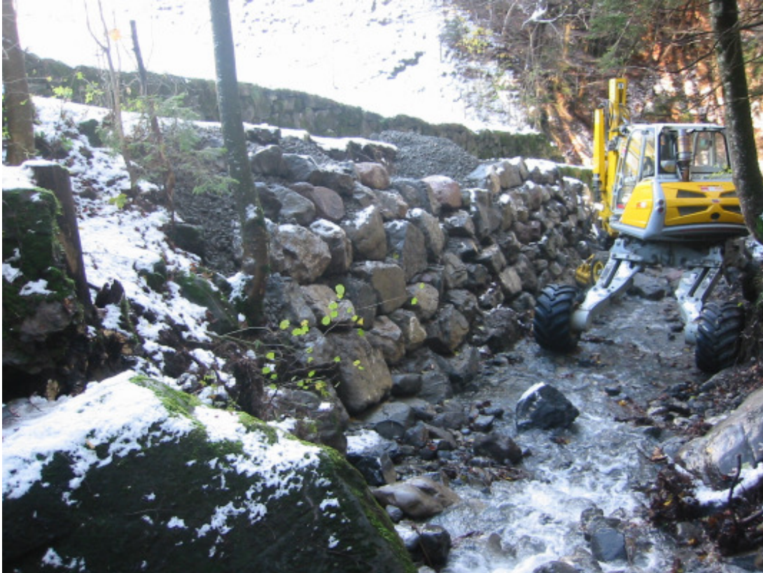
Wuhrschaden Filzbach, Filzbach
