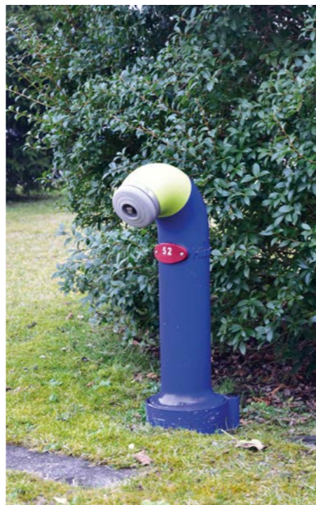
In Gemeindegebiet Glarus Nord stehen 873 Hydranten!
