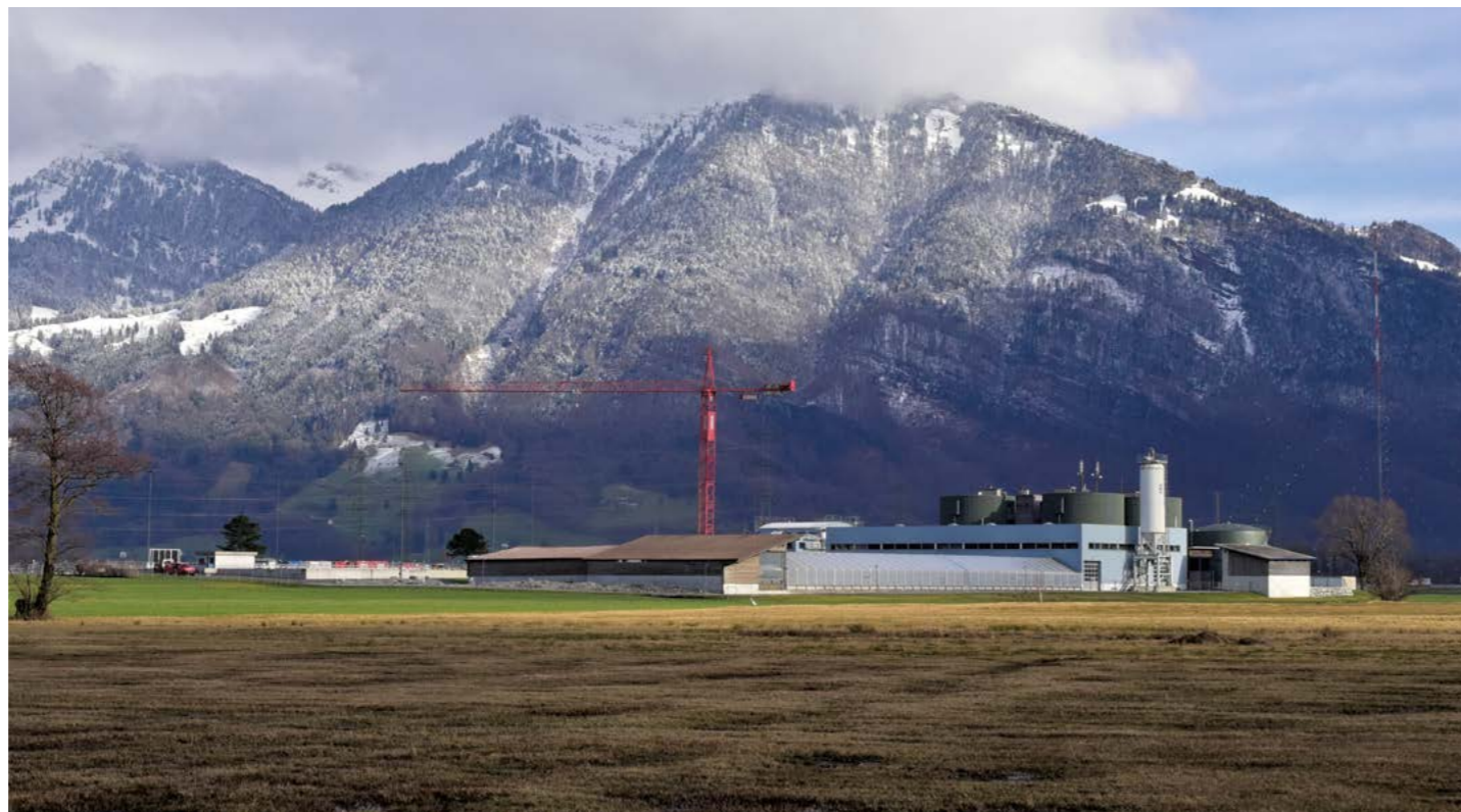
Die ARA Glarnerland in Bilten – zur Zeit im Ausbau
