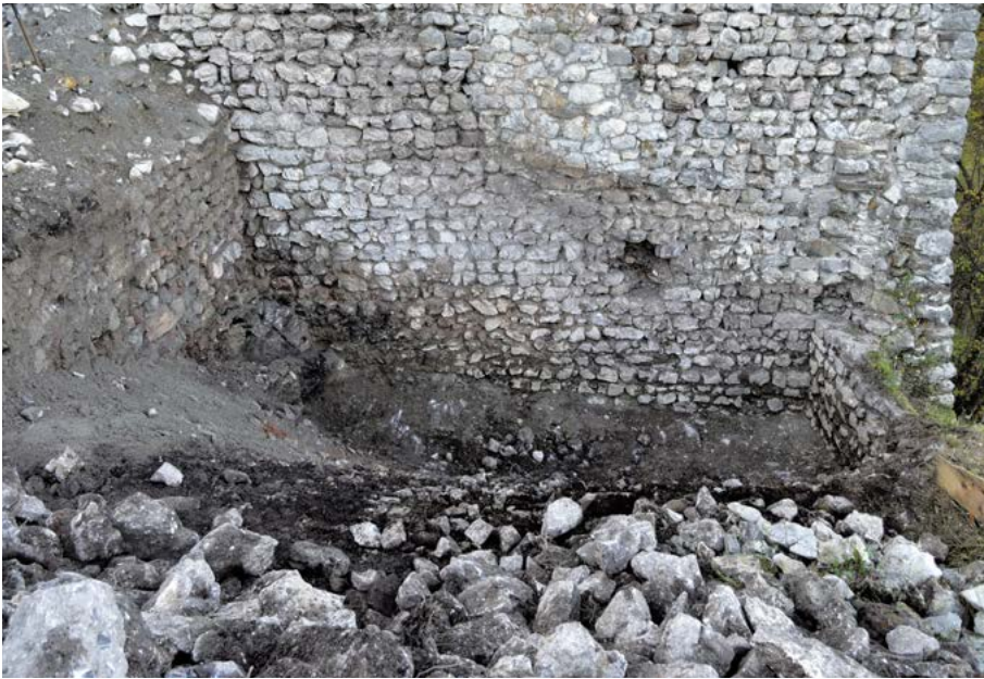
Deutliche Brandspuren an der Nordwestecke der Vorburg (Foto Steve Nann).
