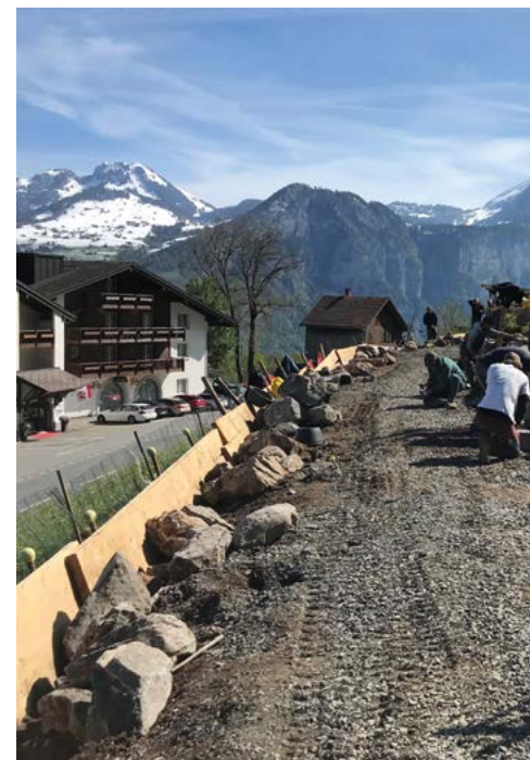
Die Gemeinde Glarus Nord saniert in Zusammenarbeit mit der Stiftung „Umwelteinatz Schweiz“ in regelmässigen Abständen Abschnitte von Trockenmauern – im Bild der Römerweg beim Ortseingang des Dorfes Filzbach.
