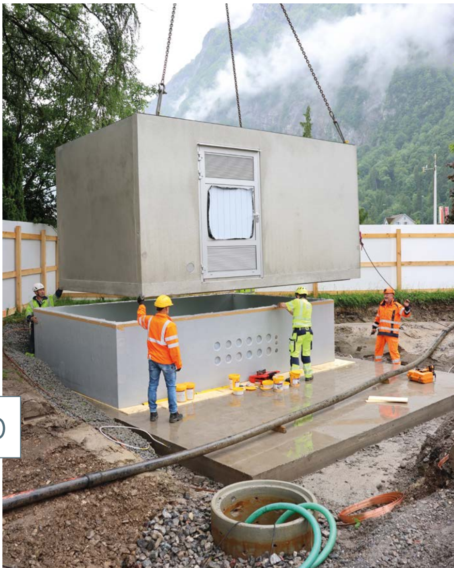
27 Tonnen wiegt die leere Trafostation.
