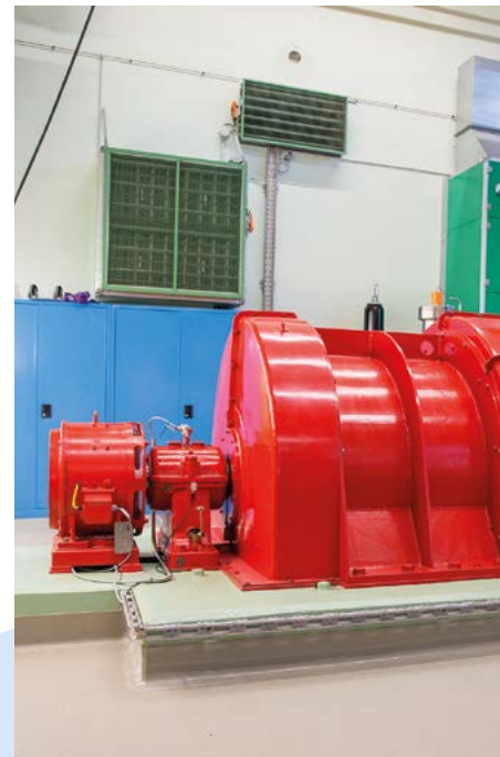
Seit 1924 produziert das Kraftwerk Risi Strom, genug für rund 4'200 Haushalte in Glarus Nord.
