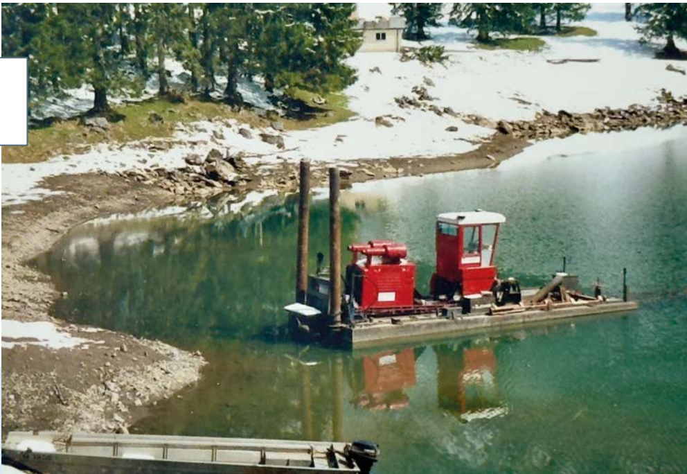
1991 wird der Obersee von Schlamm und Geröll befreit. So kann das Wasser wieder ungehindert abfließen – ein wichtiger Schritt, um mehr Strom aus Wasserkraft zu gewinnen.
